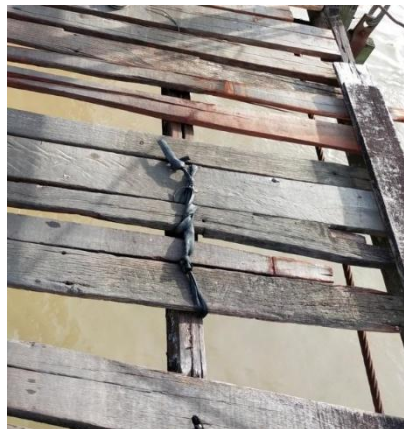
Gambar 2. Kerusakan pada Jembatan Abbanuangge
